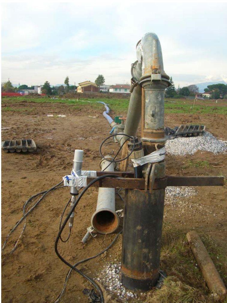
Particolare del piezometro con datalogger collocato all'interno del pozzo.
