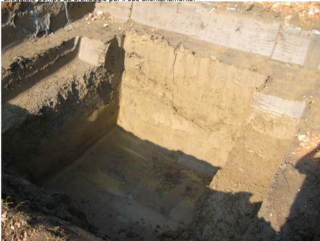
Realizzazione della buca per la collocazione del pozzo in un terreno argilloso
