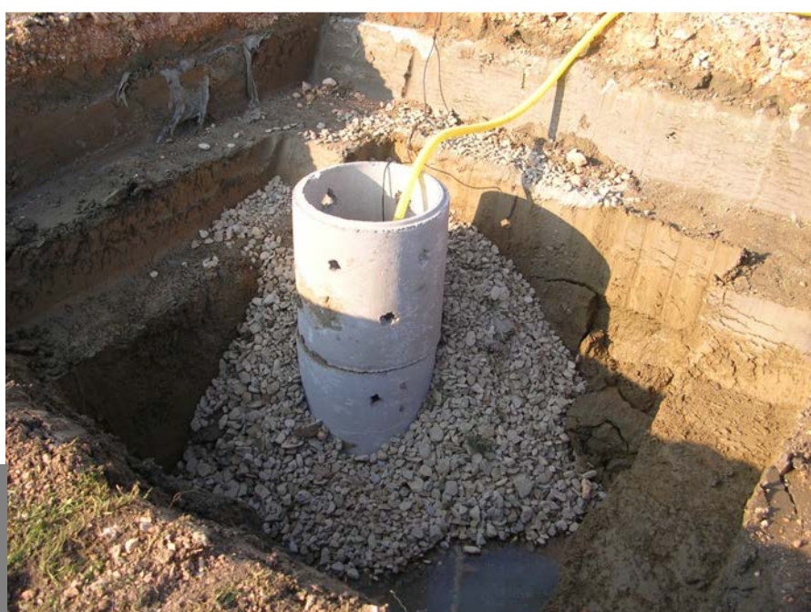
Particolare del pozzo inghiato.
