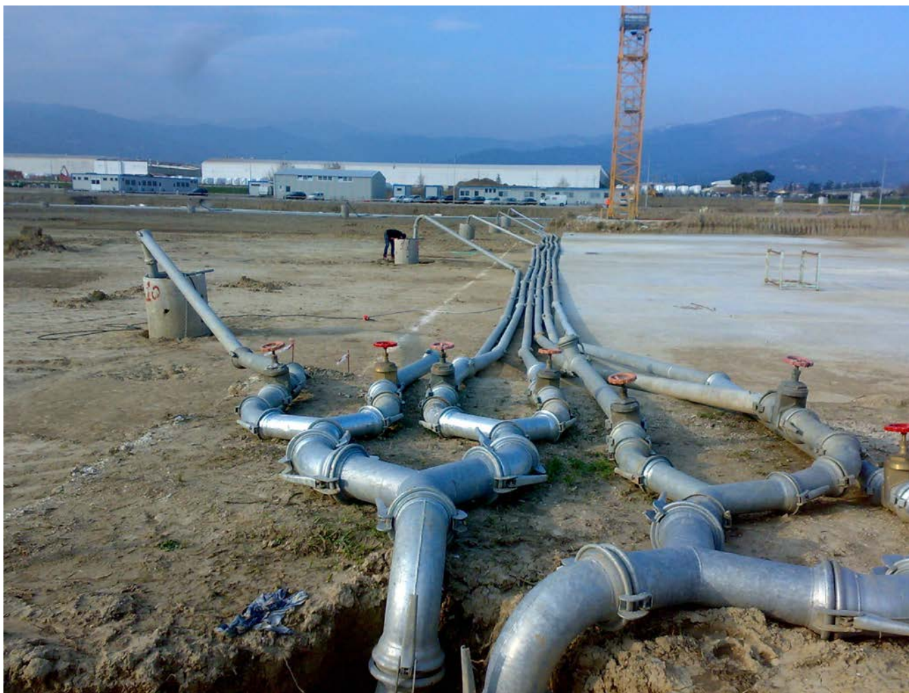
Particolare di un sistema di regimazione delle acque pompate
