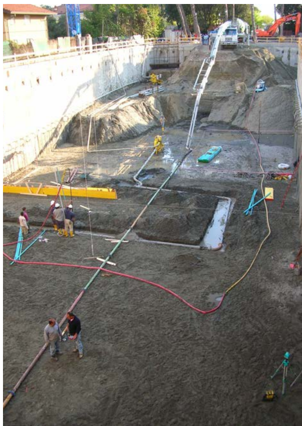
Disposizione di un impianto wellpoint sotto platea Rinterro avvenuto, inizio del getto in C.A.
