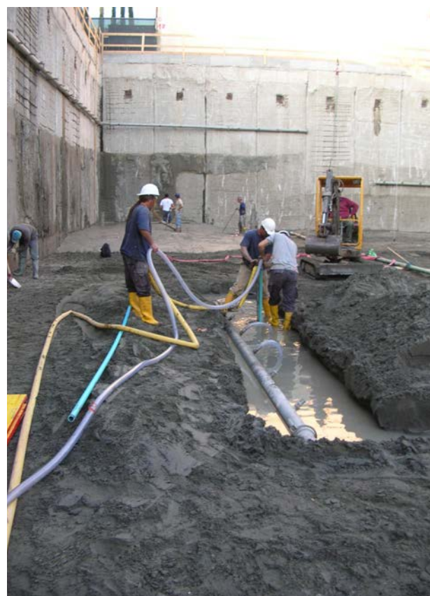
Disposizione di un impianto wellpoint sotto platea Infissione dei wellpoint in PVC a perdere
