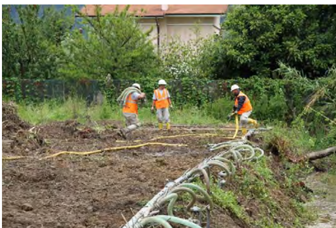
Linea wellpoint completa
