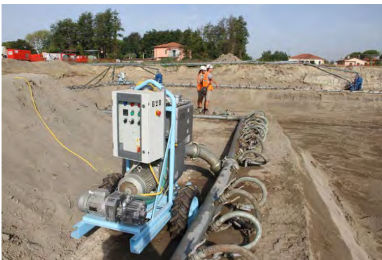
Foto d'insieme di un impianto
